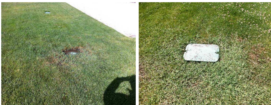
Foto 1.3. Continuación del problema de riego en una arqueta de la pradera del parking
