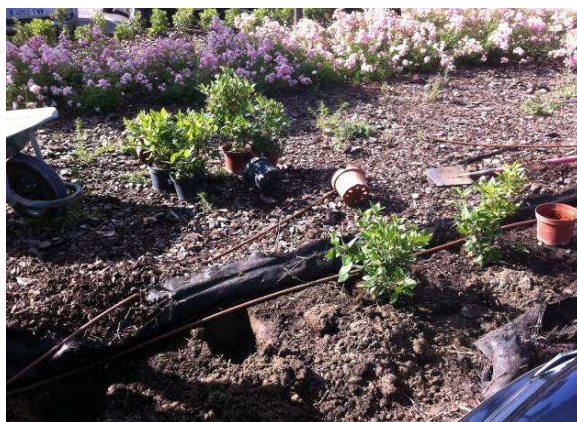
Foto 1.2. Problema de riego en la pradera del parking
