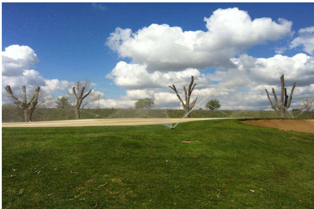
Foto 1.5. Vista del funcionamiento de la nueva instalación de riego en greens.
