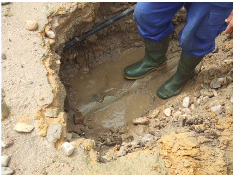
AVERIA EN TUBERÍA DE FIBROCEMENTO EN LA HÍPICA (FOTO TOMADA EL 26 DE AGOSTO)
