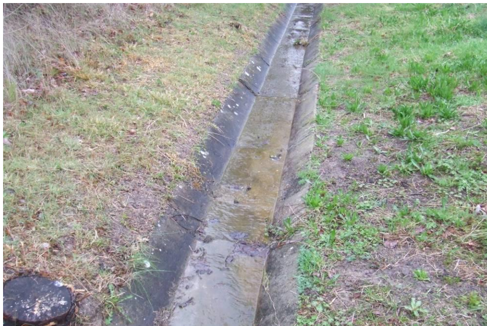
CANELETA EN LA PARTE DERECHA DEL HOYO 18
