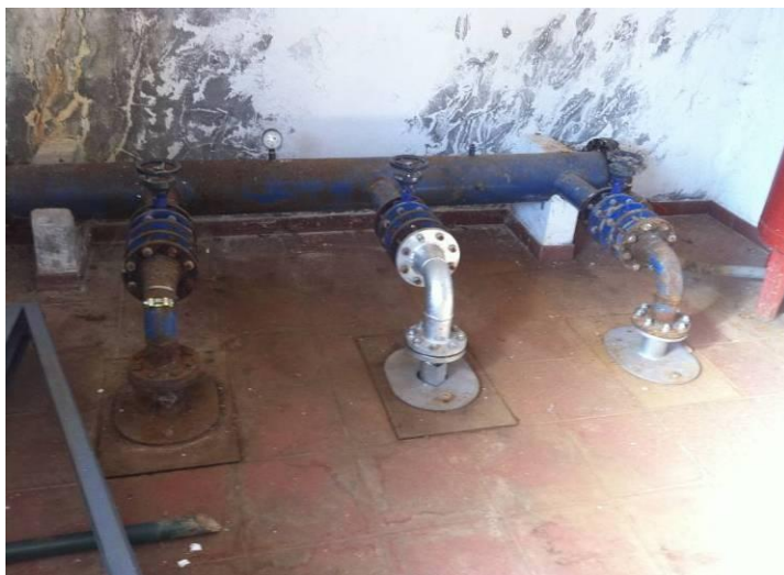
Foto 10. Detalle de las tres bombas de aspiración del grupo de impulsión.
