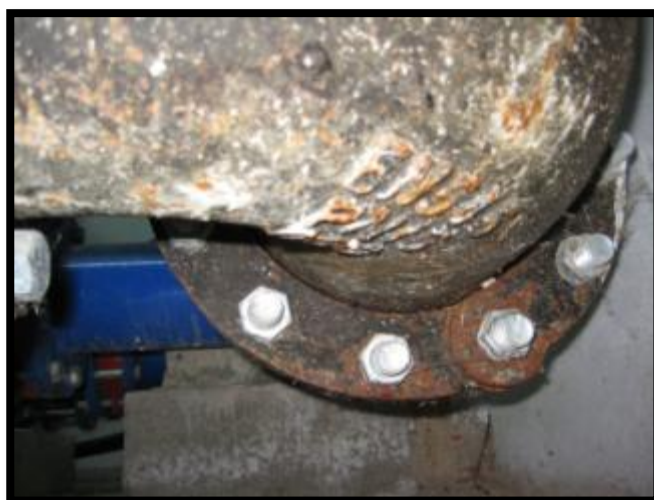
Foto 21. Brida de hierro fundido deteriorada en la caseta de bombeo de la zona baja.
