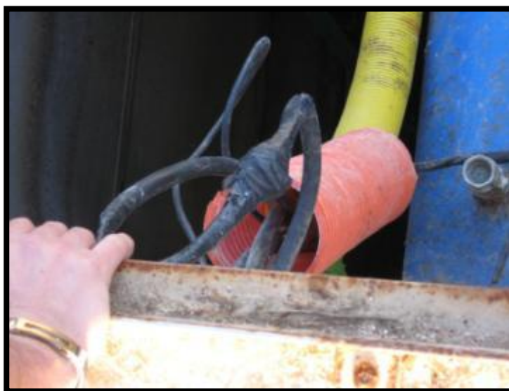
Foto 14. Los cables de corriente se conectan a través de una clema tapada con cinta aislante.
