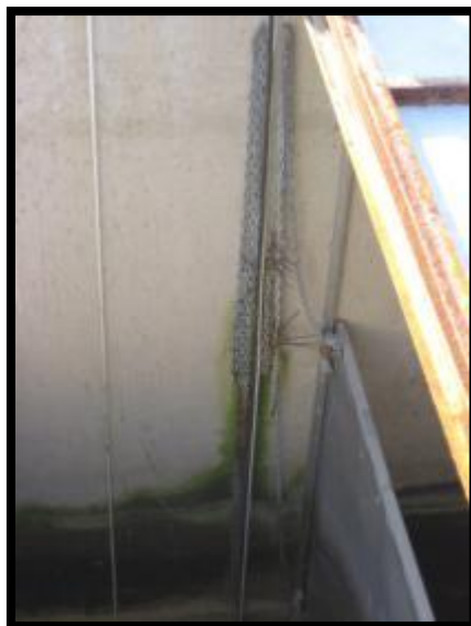
Foto 7. Las cadenas para subir los cuerpos de malla de filtrado no están enganchadas a los 5 cuerpos más profundos. No hay cadena suficiente.
