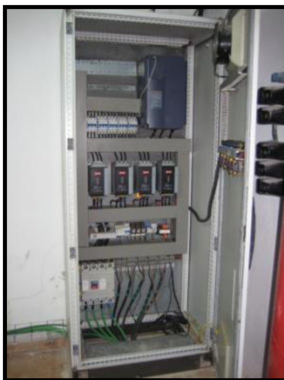
Foto 18. Vista del armario eléctrico del bombeo
