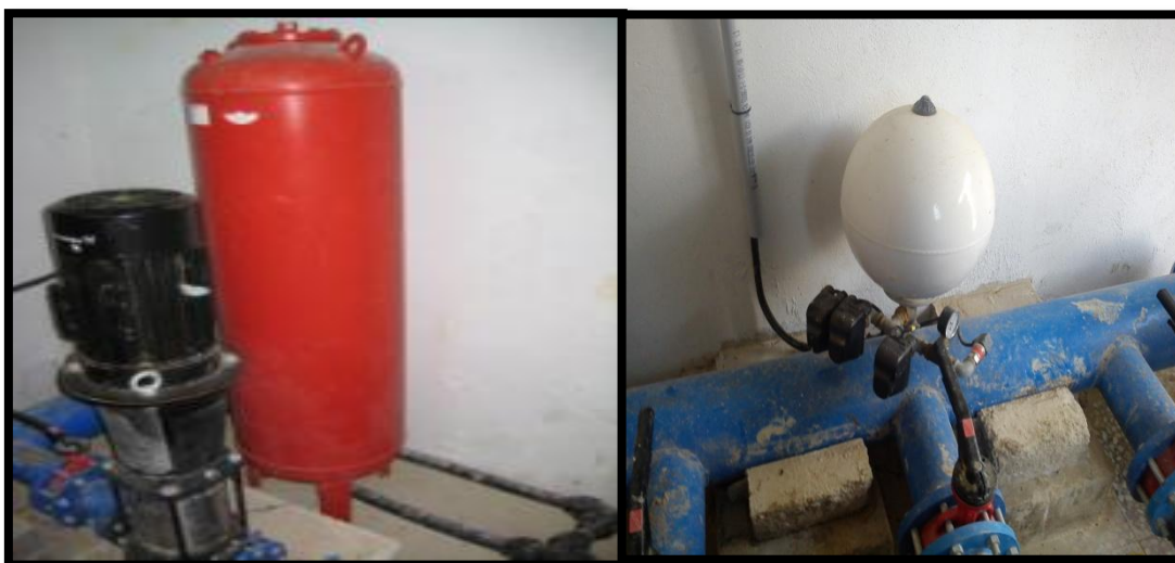
Foto 22. A la izquierda, presostatos y transductor deberían estar en la parte superior del calderín. A la derecha, calderín insuficiente para amortiguar los golpes de ariete.
