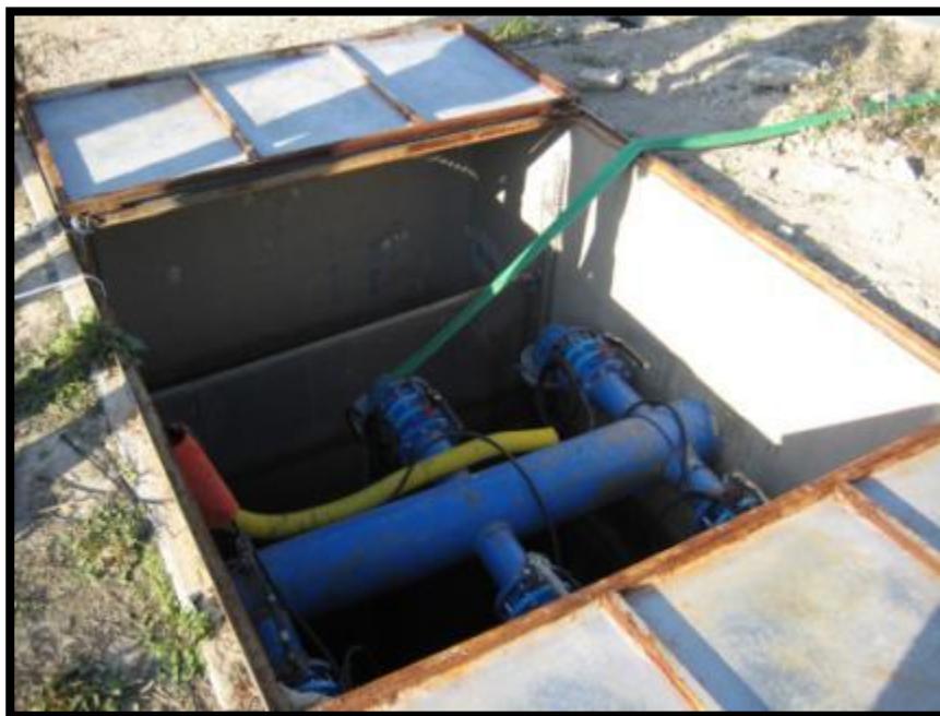
Foto 16. Las dimensiones del aljibe no garantizan una reserva adecuada de agua en caso de rotura u obstrucción de la captación desde el lago.
