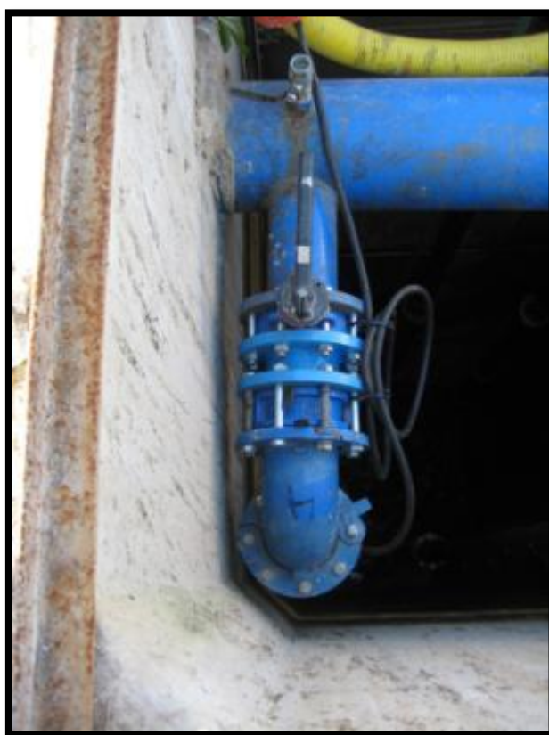
Foto 15. El colector se encuentra en mal estado debido a la selección del material dadas las condiciones presentes. Además, se encuentra empotrado a la pared de hormigón del aljibe.
