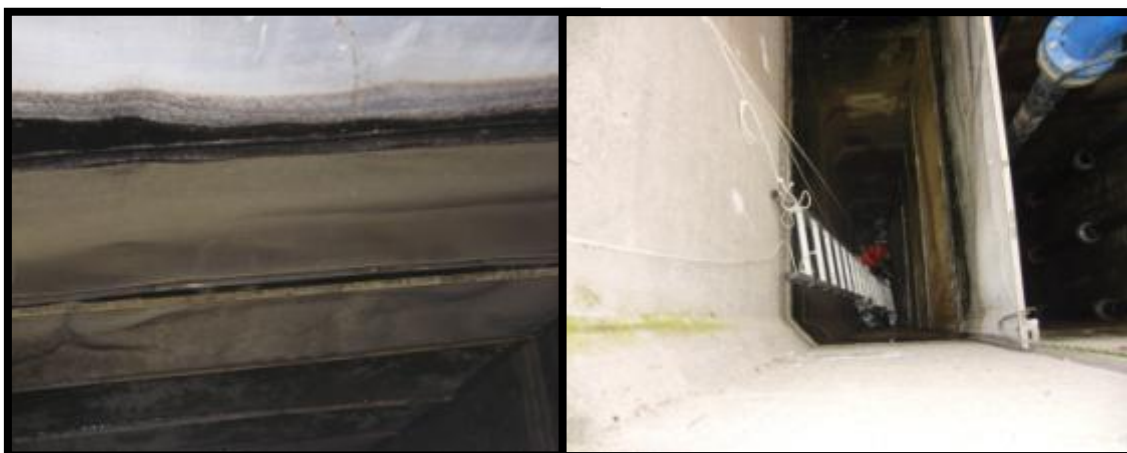
Foto 6. La unión entre los cuerpos de malla de filtrado está separada y deformada, permitiendo que el agua sin filtrar llegue a las bombas.
