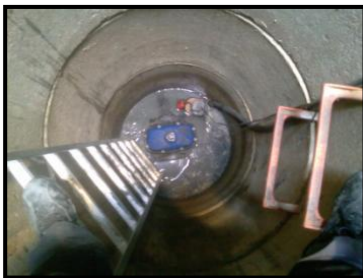
Foto 2. Vista de la válvula de cierre. El cuerpo cilíndrico de hormigón ha sido vaciado mediante la bomba instalada por la empresa constructora que se observa junto a la válvula. Una escalera adicional es necesaria para llegar hasta la válvula.
