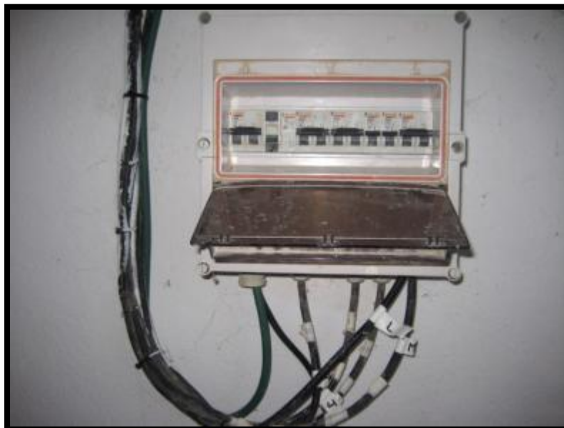
Foto 19. Vista del cuadro eléctrico de los satélites. El diferencial está puenteado.
