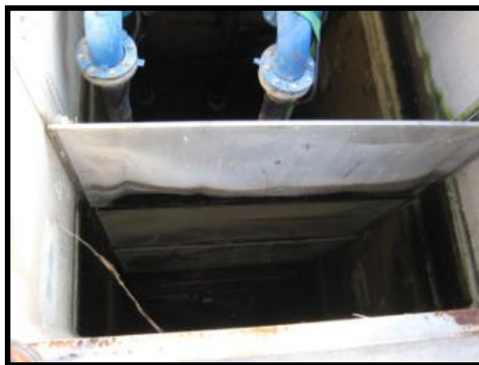
Foto 4. Sistema de filtrado. Separa agua filtrada en el aljibe de riego.
