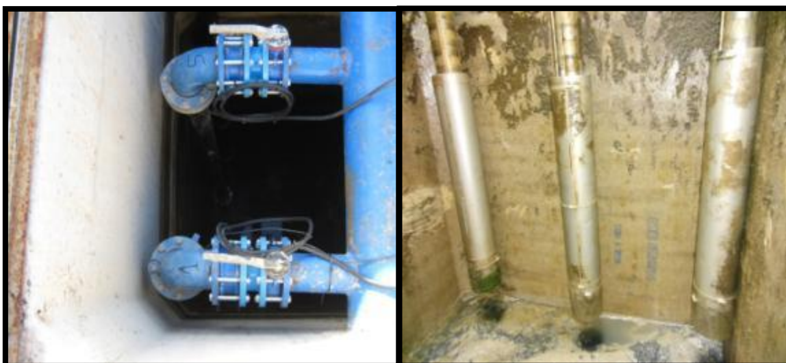
Foto 11. Hay menos de 10 cm de separación entre las bombas y la pared del aljibe. La bomba 5 (bomba derecha, foto derecha) está en contacto con la pared.
