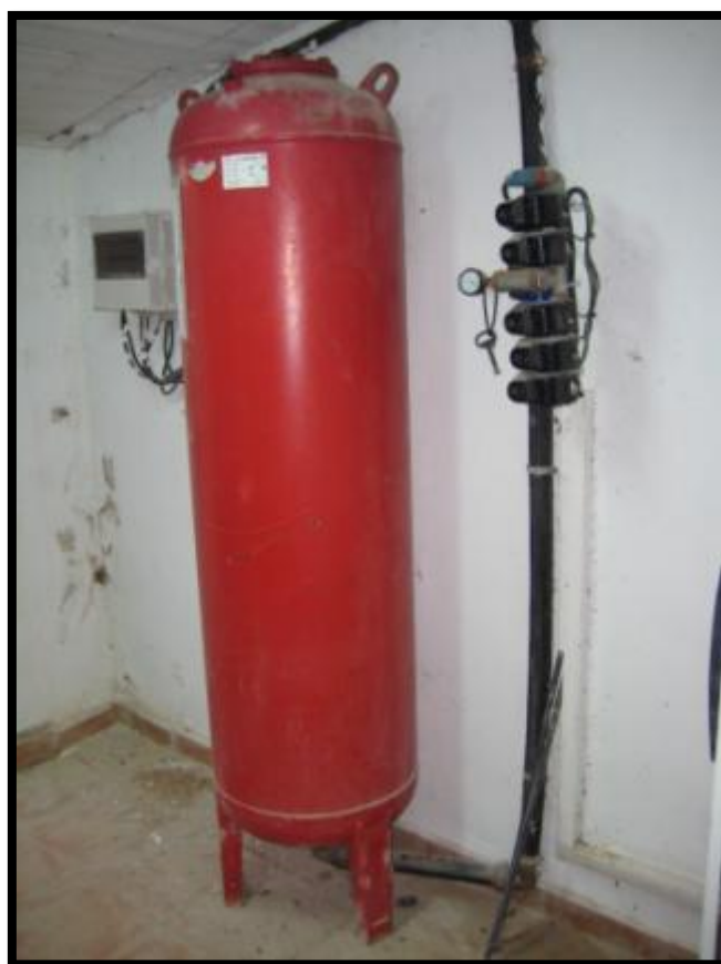
Foto 17. El transductor de presión del calderín está en paralelo al mismo y no realiza ninguna función. No hay llave de corte ni tubería de vaciado para limpieza.
