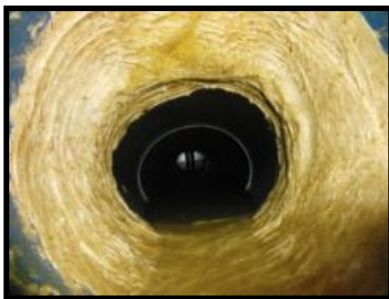
Foto 3. El diámetro de entrada al aljibe es inferior a 300 mm. Al fondo, válvula de paso desde la captación del lago hasta el aljibe.
