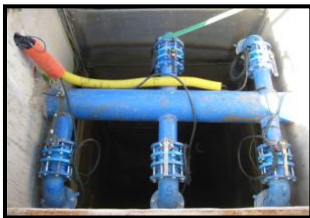
Foto 12. Una de las bombas no está confrontada respecto al colector. Este diseño puede derivar en problemas de funcionamiento potenciales.
