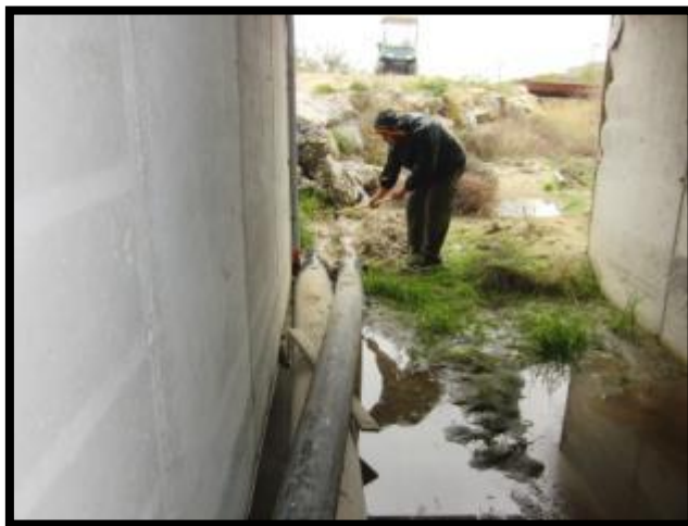
Foto 24. Las tuberías de recirculación del lago y de la captación del bombeo de la zona baja se cruzan y descansan una sobre otra.
