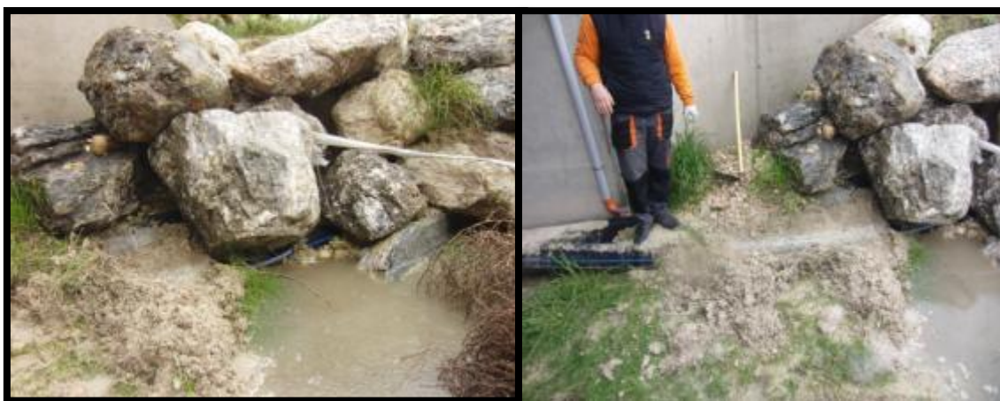
Foto 23. La escollera descansa sobre las tuberías sin protección alguna.
