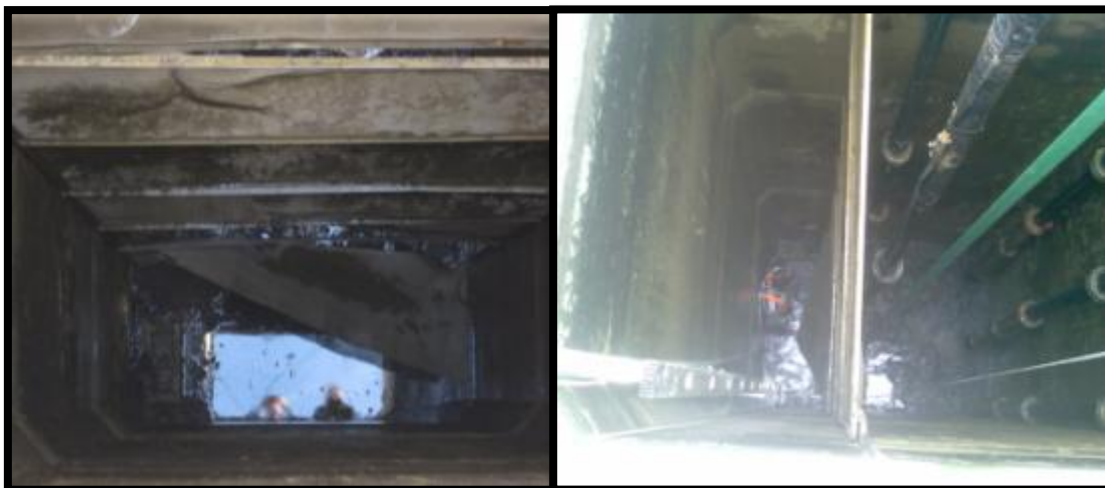
Foto 5. La malla del sistema de filtrado está rota y despegada en los cuerpos más profundos. El sistema es inservible en este estado.
