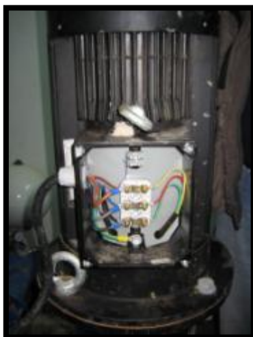
Foto 25. Las protecciones térmicas del motor están desinstaladas.
