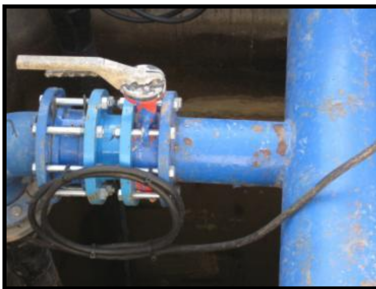
Foto 9. El hierro fundido de las llaves de paso de las bombas está desgastado y oxidado por la humedad ambiental y la calidad del agua circulante.
