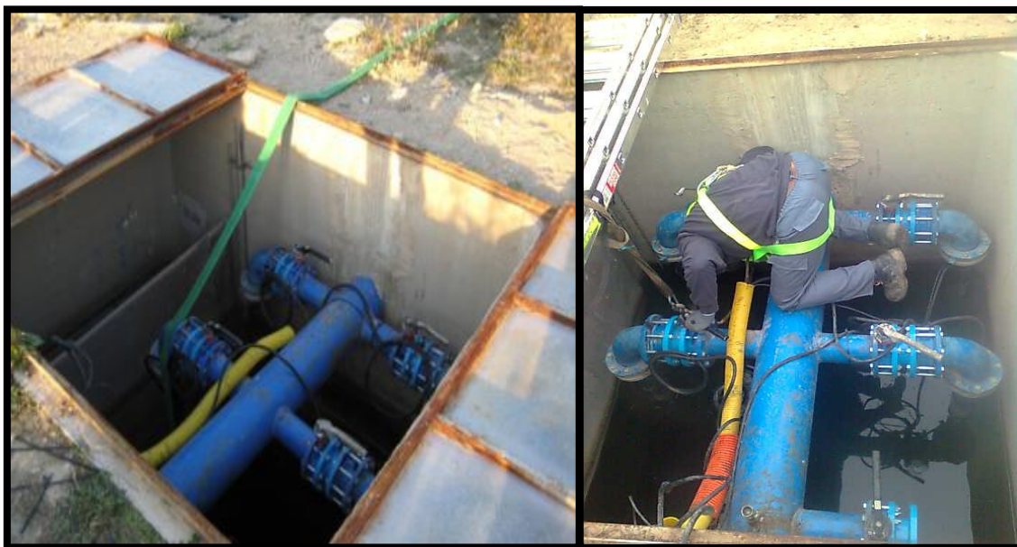
Foto 8. El cierre y apertura de las llaves de paso de las bombas es totalmente inoperativo y requiere medidas extraordinarias de seguridad.
