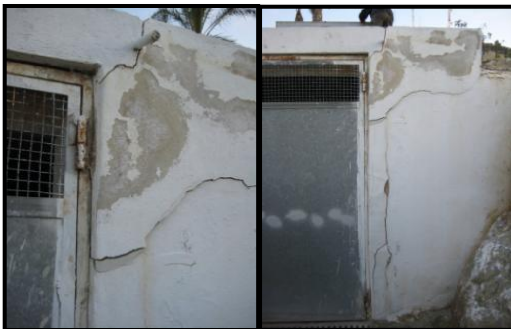
Foto 20. La caseta de bombeo se encuentra en muy mal estado.
