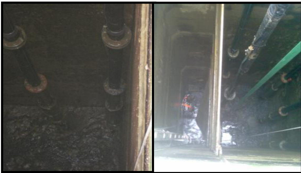
Foto 13. Los lodos y los fangos se acumulan en el sector del aljibe donde aspiran las bombas debido a la inoperatividad del sistema de filtrado. En la foto derecha, se aprecia como los lodos se concentran en el sector donde las bombas aspiran.
