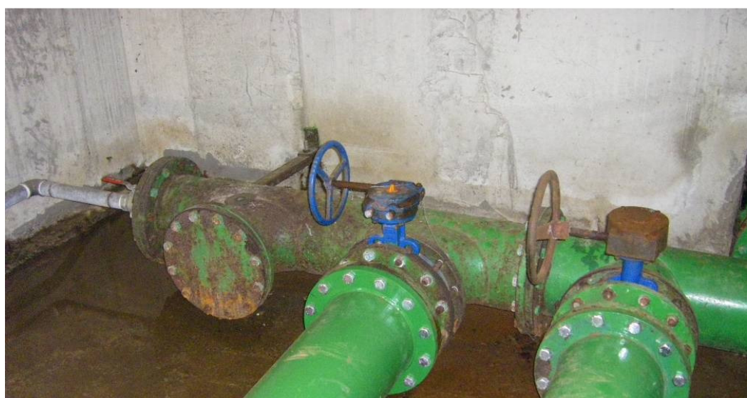
Foto 2. Detalle de la corrosión y humedad existente en el cuarto de bombeo.
