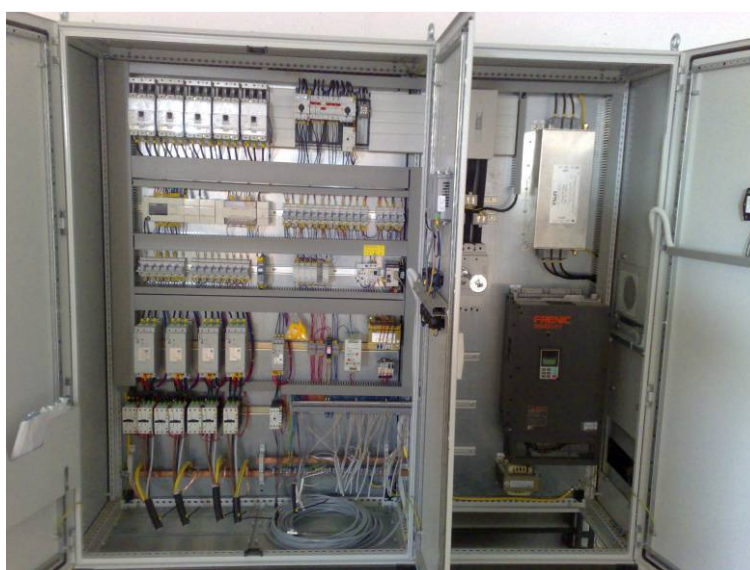
Foto 9. Vista interior del cuadro de mandos.
