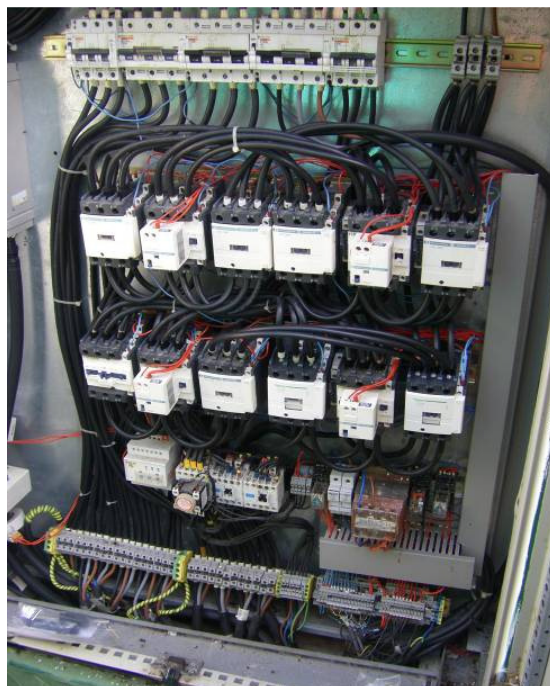
Foto 3. Vista general del cuadro de energía eléctrica con los contactores montados en estrella triángulo.
