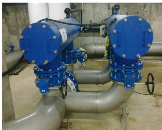
Foto 7. Filtro automático de maya para la impulsión.
