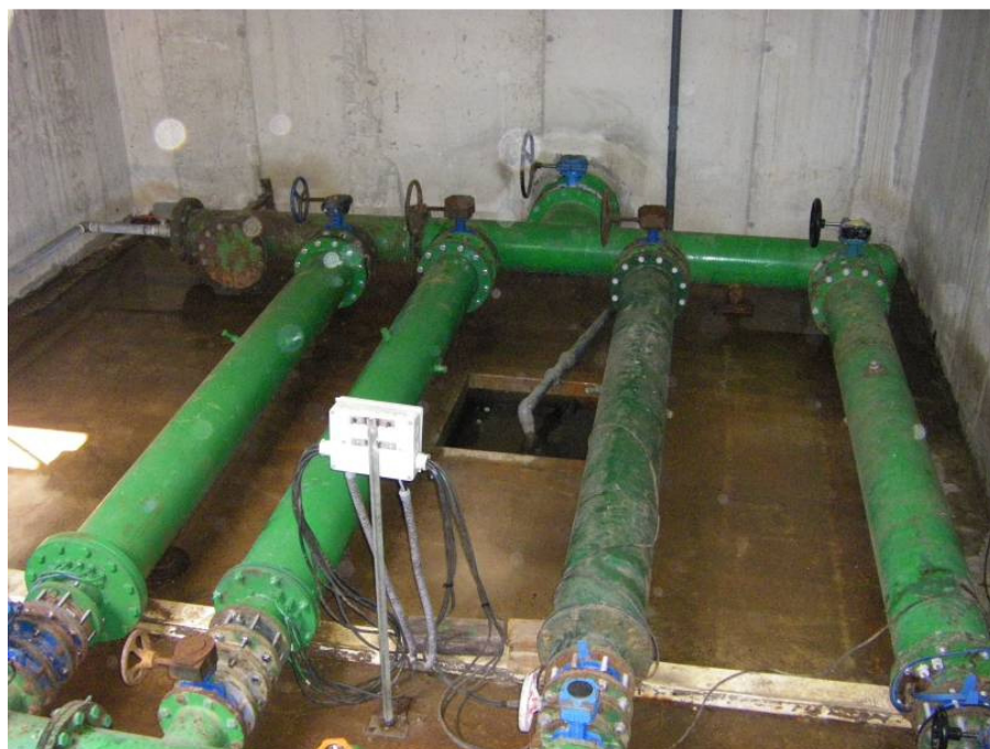
Foto 1. Vista general del grupo de presión.
