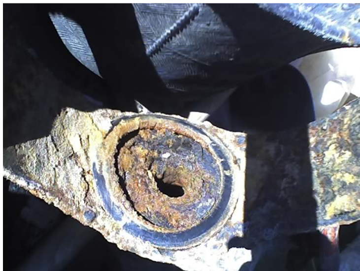
Foto 4. Detalle de un collarín del sistema de riego de El Saler obstruido debido a la corrosión.
