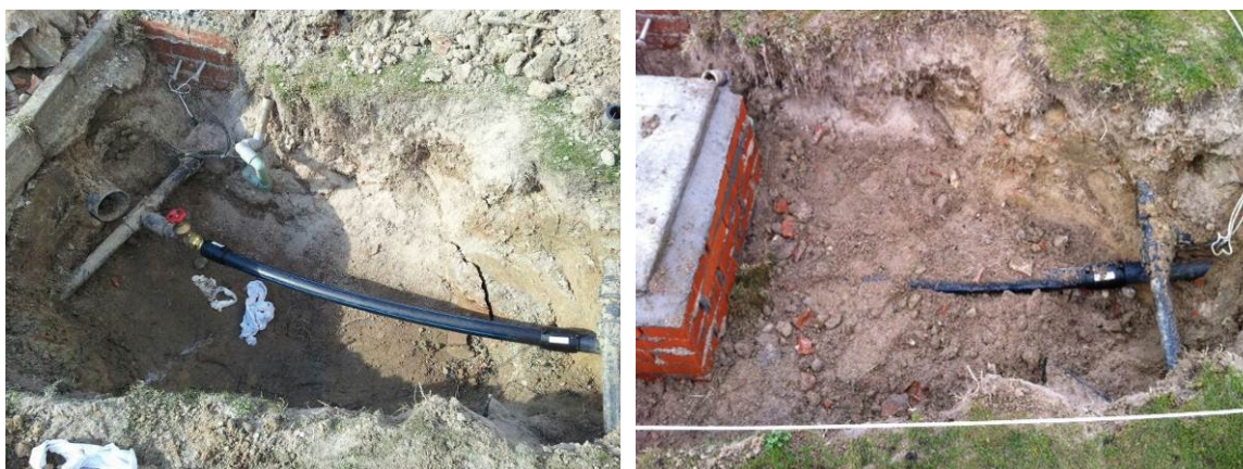
Foto 2. Nueva llave de entrada al circuito de la pradera.
