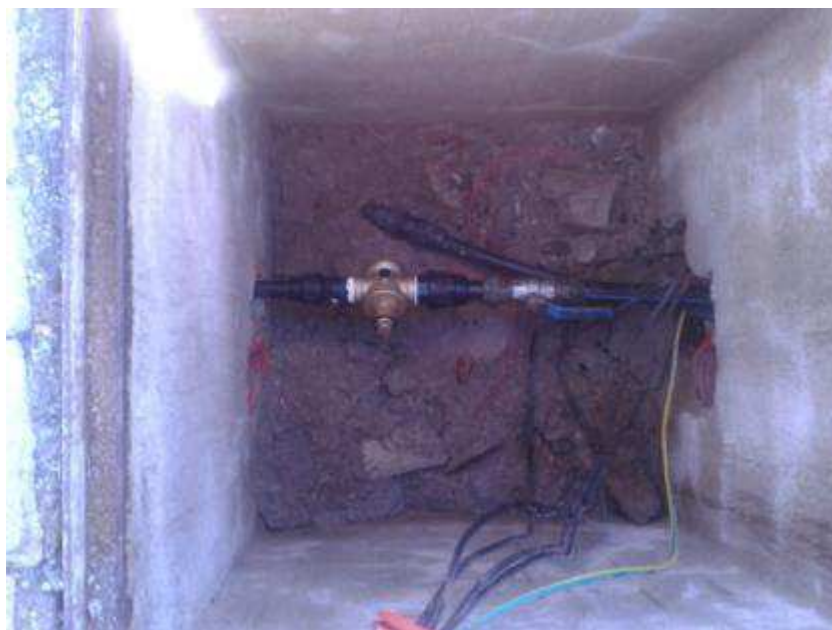
Vista regulador de presión pradera. Foto 1.1
