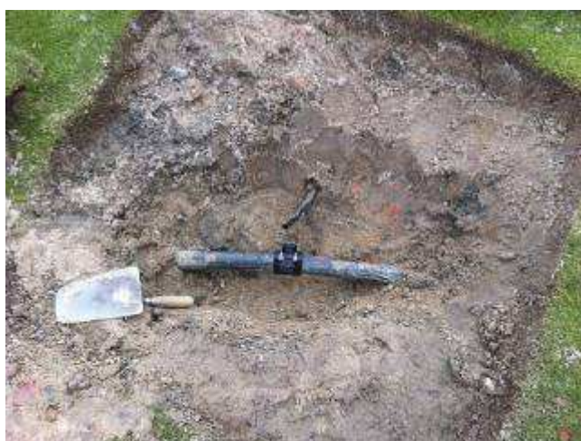
Vista avería riego. Foto 1.1
