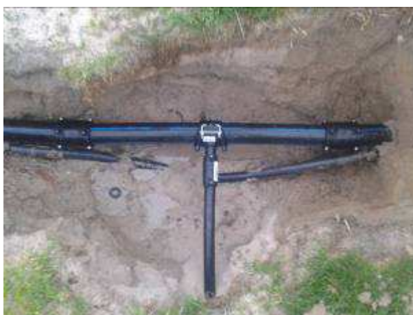
Vista avería de riego arreglada Foto1.1
