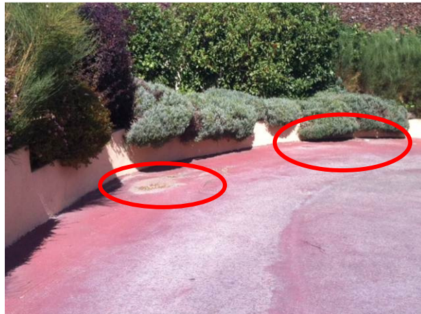
Foto 3. Restos de arena en la rampa de bajada de buggies.
