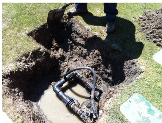
Foto 2. Detalle de una de las averías de riego de la pradera.
