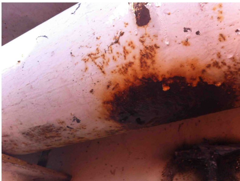
Foto 7: Detalle de avería en la tubería general.
