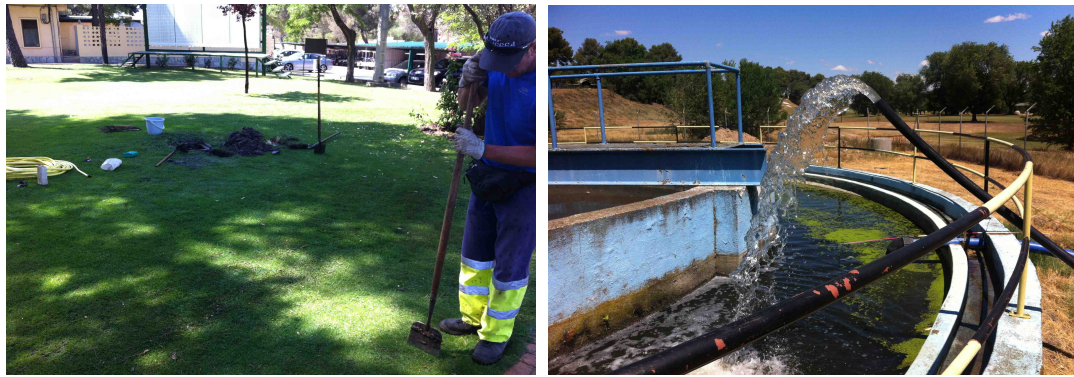
Foto 6: Detalle de avería en el jardín de la casa club (Izq) y de la nueva canalización de la depuradora a los depósitos (Dcha).
