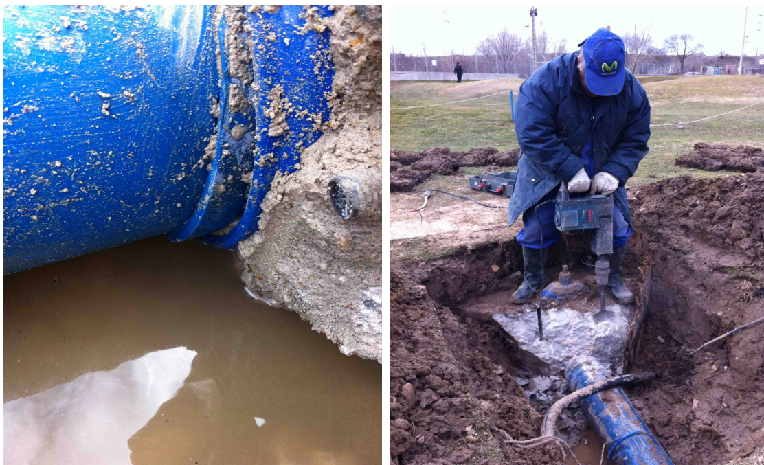
Foto 7: Detalle de la rotura de la tubería (nótese su reducido grosor) y encofrado de toda la válvula respectivamente.
