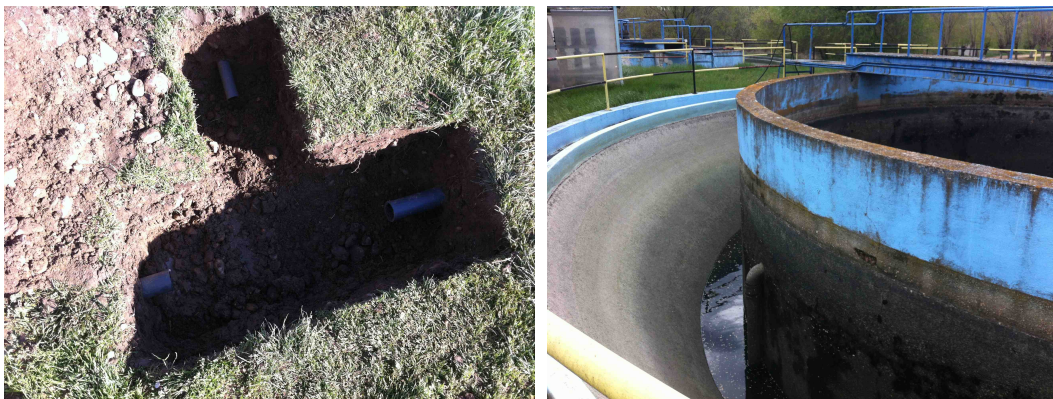
Foto 10: Detalle de avería de riego en el hoyo 6 (Izq) y del vaciado de los depósitos (Dcha)
