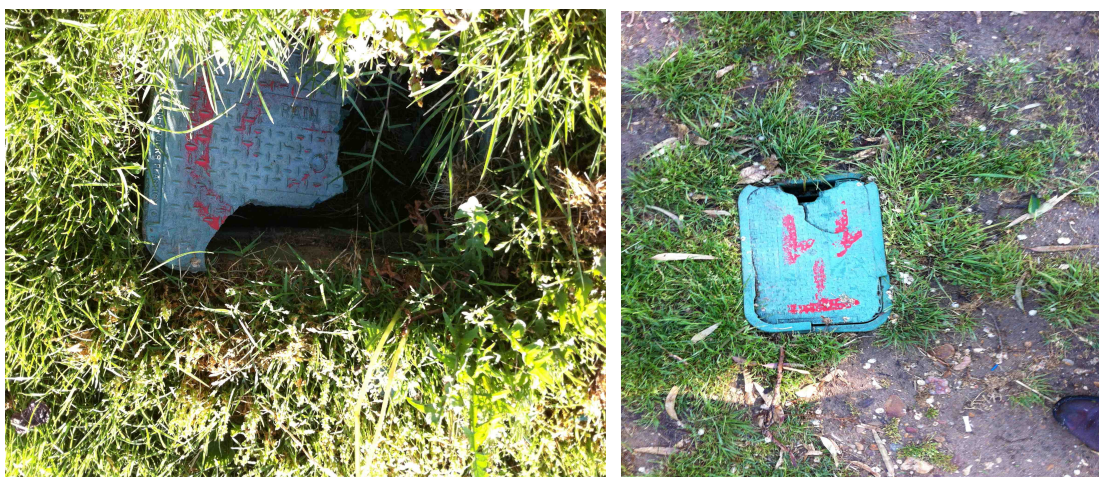
Foto 5: Detalle del estado de las arquetas de riego.
