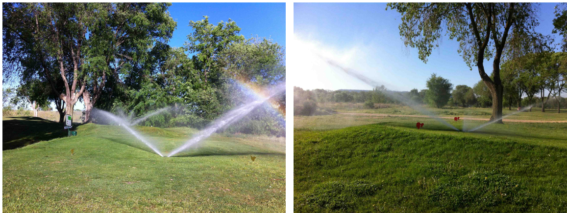
Foto 6: Detalle de aspersores dentro de plataformas de Tees. Nótese como el agua es arrojada fuera de las plataformas.
