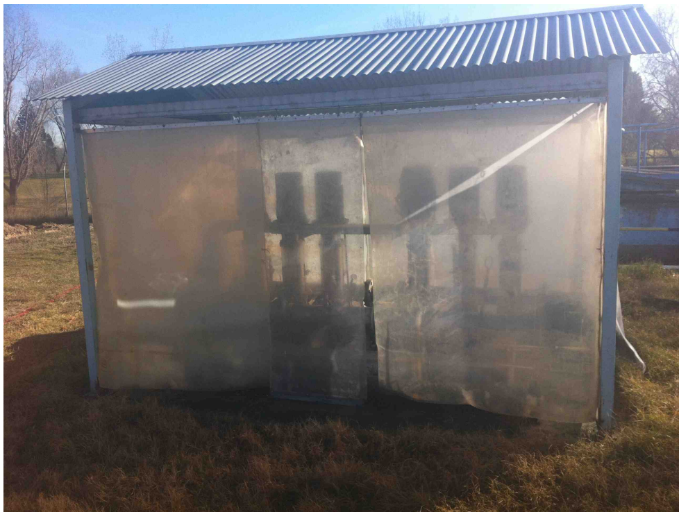
Foto 1: Detalle del sistema de bombeo. Nótese que las bombas se encuentran a la intemperie expuestas a los agentes atmosféricos.
