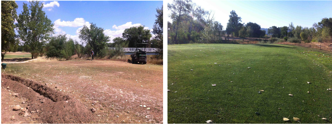
Foto 6: Detalle del cambio producido en el Tee 4 pasado un mes de su renovación.
