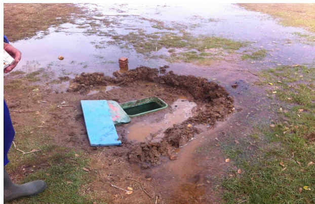
Foto 11: Detalle de avería en Hoyo 14
