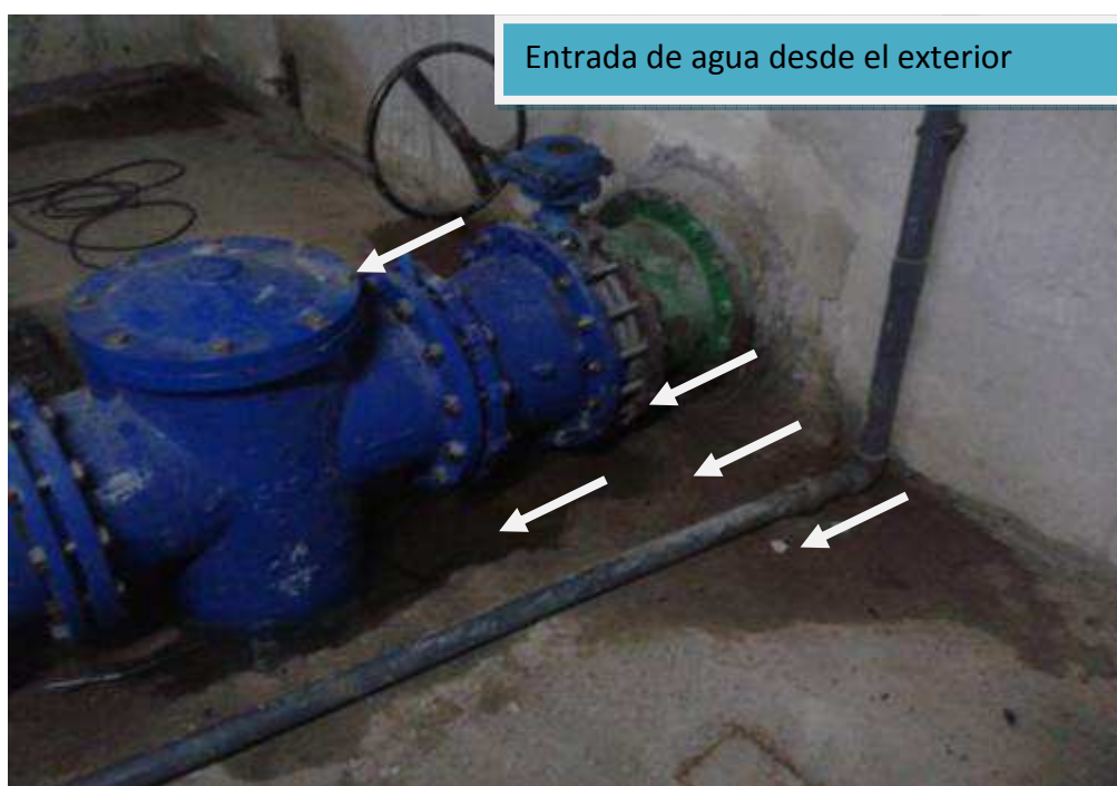
Vista tubería de admisión procedente del lago
