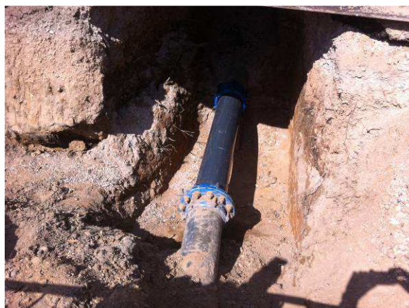
Foto 5.1. Avería localizada en la entrada del sistema de bombeo
