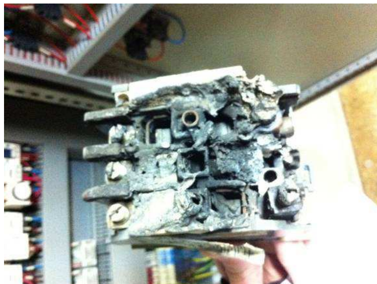
Vista de contactor quemado
