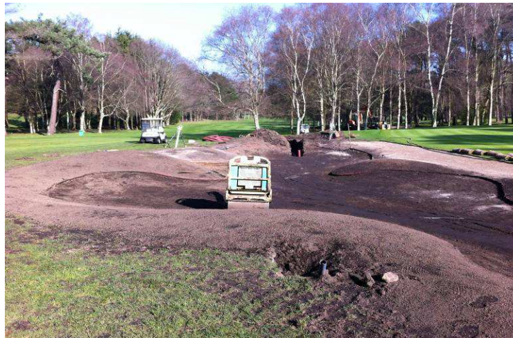
Foto 5.1. Detalle de un bunker y la dificultad de drenaje
