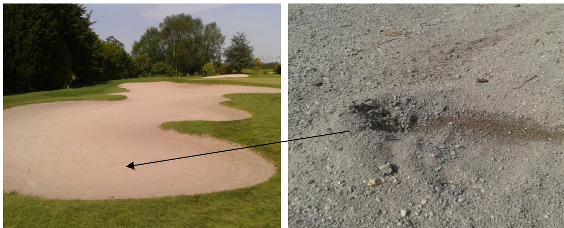
Foto 6.1. Vista bunker green 13. Apenas 2 cm de arena.
