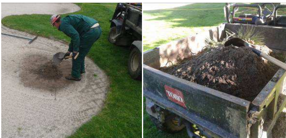
Eliminación de capa negra en zonas de acumulación de agua. Foto 5.3
