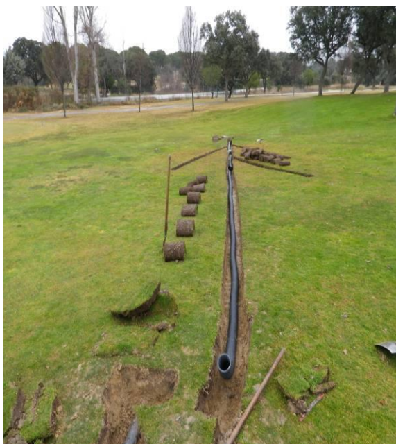
Foto 4. Drenaje calle hoyo 9.
