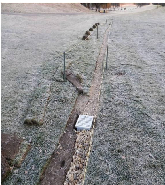
Foto 4. Drenaje salida tee del 6.
