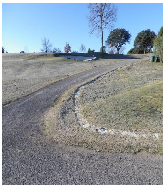
Foto 5. Drenaje tee del 5.
