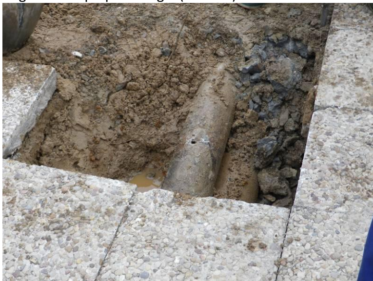
Foto 10. Tubería de llenado de la piscina con una pequeña fuga.
