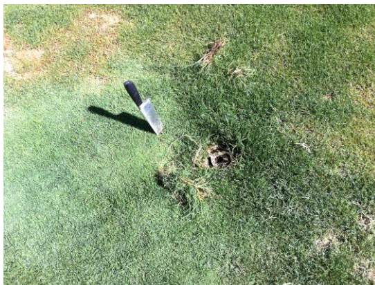
Foto 16. Punto bajo de drenaje cubierto por el césped.
