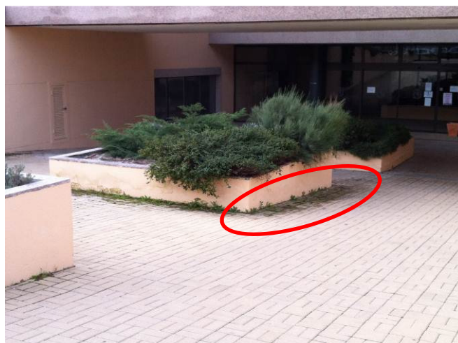
Foto 6. Detalle de las malas hierbas en los parterres de la rampa de acceso a la tienda.
