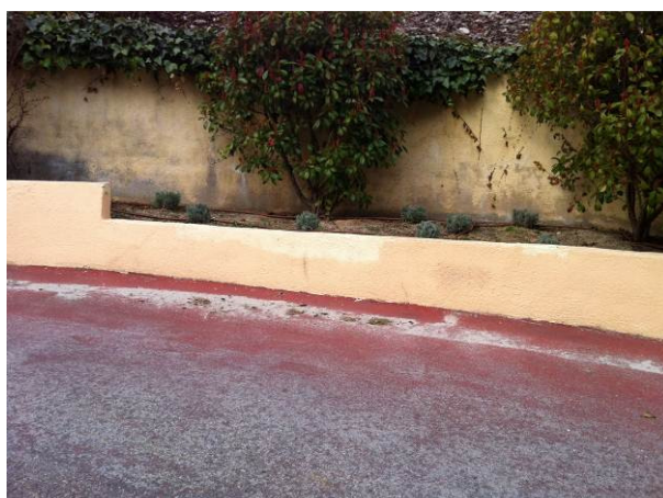
Foto 5. Restos de arena en la rampa de acceso al campo.
