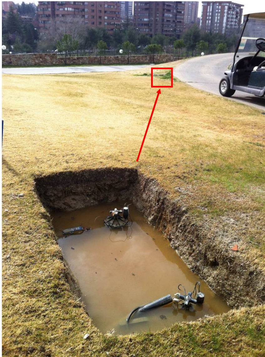
Foto 2. Detalle de la acumulación de agua en la arqueta y hacia donde habría que conducir el drenaje.
