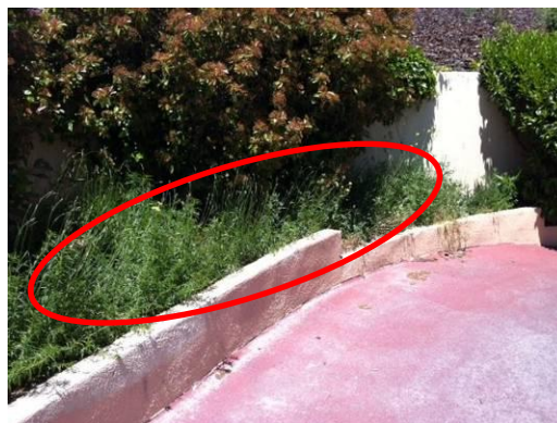
Parterre de la rampa lleno de malas hierbas.
