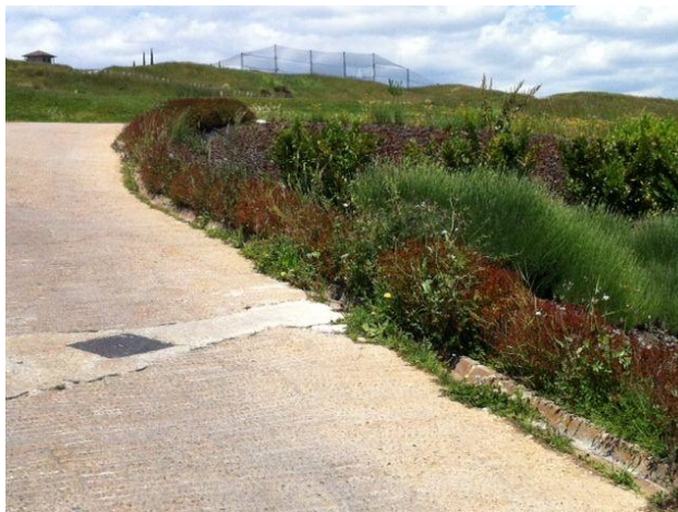
Zona sin mantenimiento alguno.
