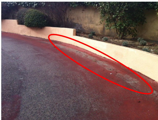
Foto 7. Restos de arena en el la rampa de acceso al campo.
