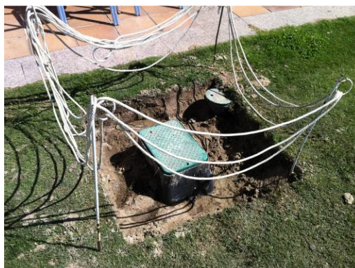
Foto 3. Avería en una electroválvula antes de ser reparada.
