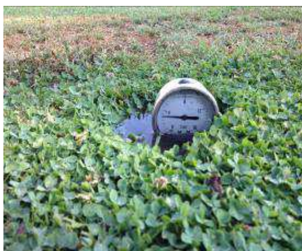
Presión del circuito con un ensayo de riego normal nocturno.
