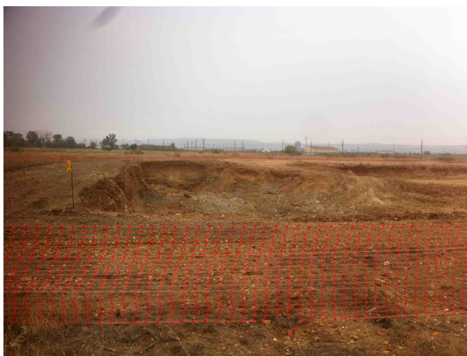
Foto 12: Detalle del estado actual de la obra de la balsa.
