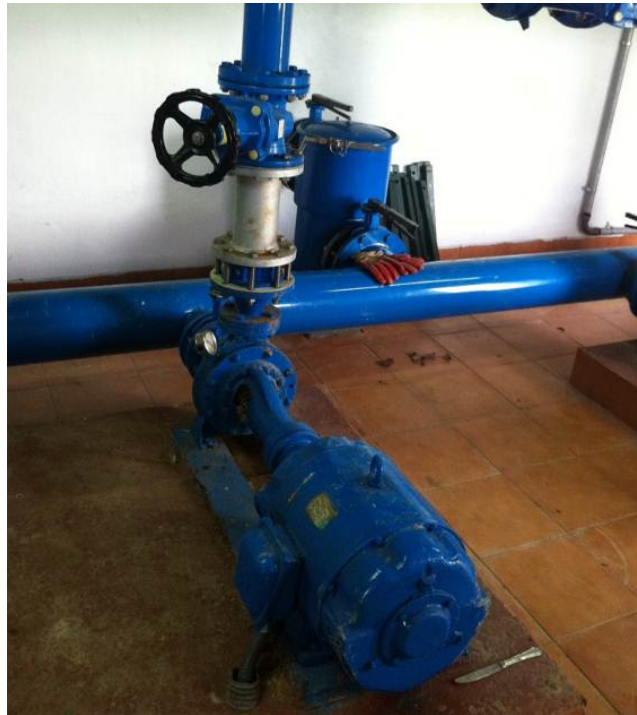
Bomba empleada en la estación de bombeo del campo de la RSGN.
