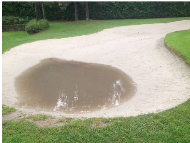
Foto 13. Estado general de un bunker no reformado.
