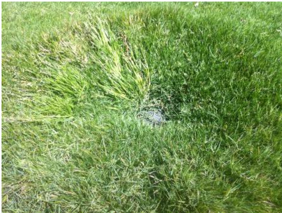
Aspersor cubierto por el césped, provocando su mal funcionamiento
