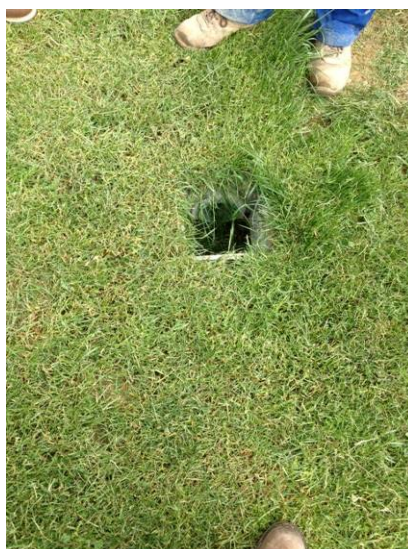
Foto 4. Arqueta sin tapa.
