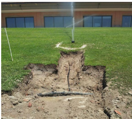
Foto 1. Avería en la tubería del aspersor
