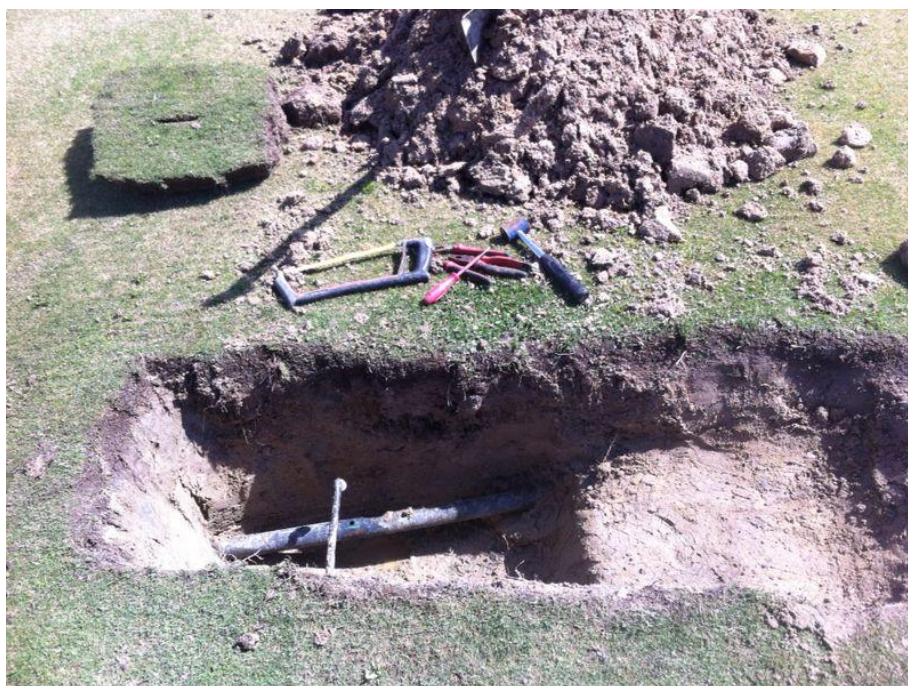
Foto 3: rotura de tubería fase 1
