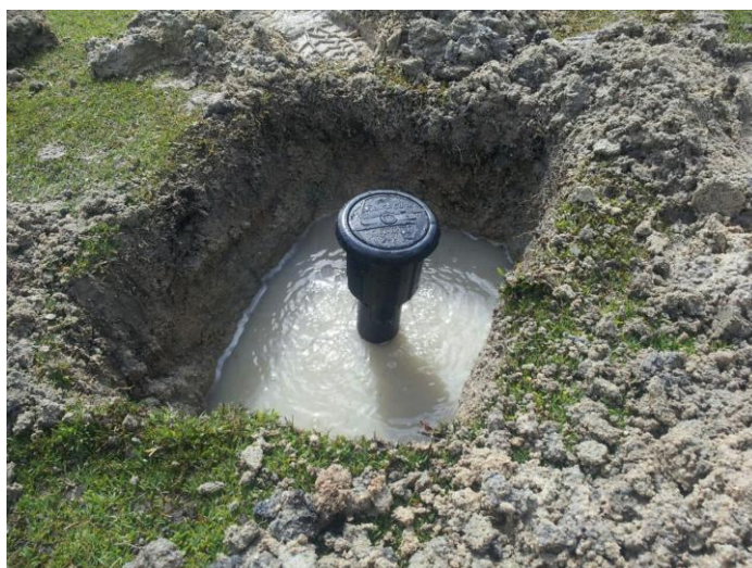
Foto 6. Pérdida de agua por el aspersor
