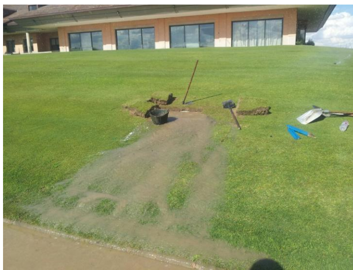
Foto 2. Fuga de agua por el collarín
