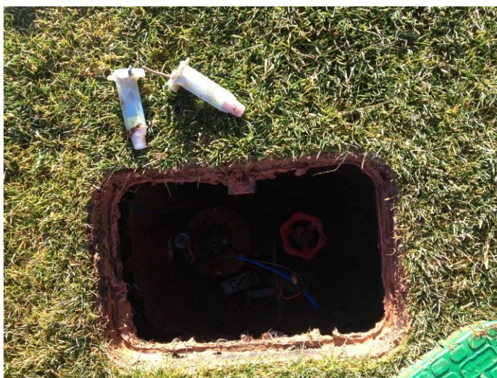
Foto 9. Arqueta de registro.
