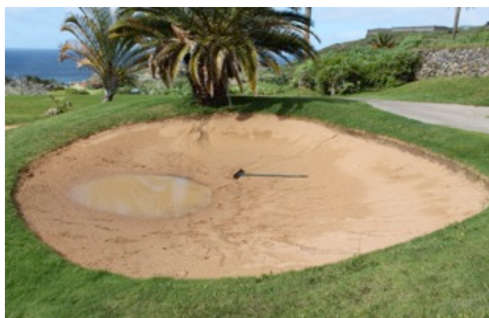
Imagen 18: Bunker encharcado por fallo en la red de drenaje.
