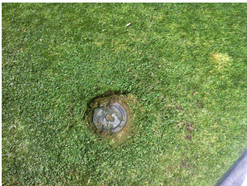
Foto 15. Aspersor limpio sin nivelar.
