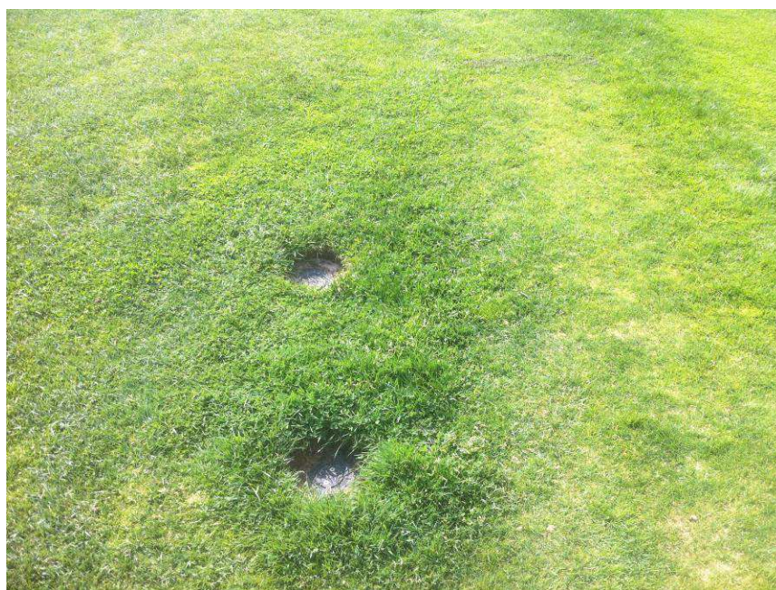
Foto 4. Aspersores sin nivelar.
