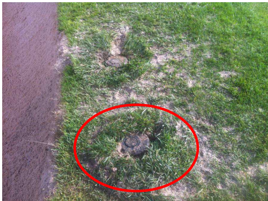
Foto 10. Tepes mal puestos.
