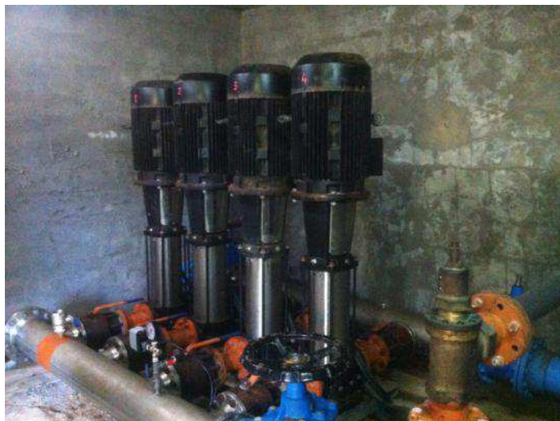
Foto 3. Equipo de bombas.
