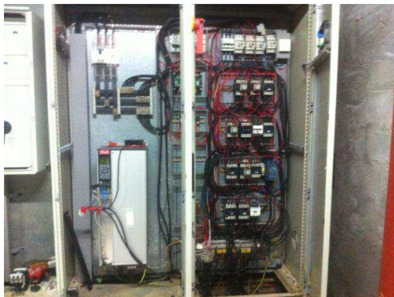
Foto 1. Cuadro eléctrico manipulado.
