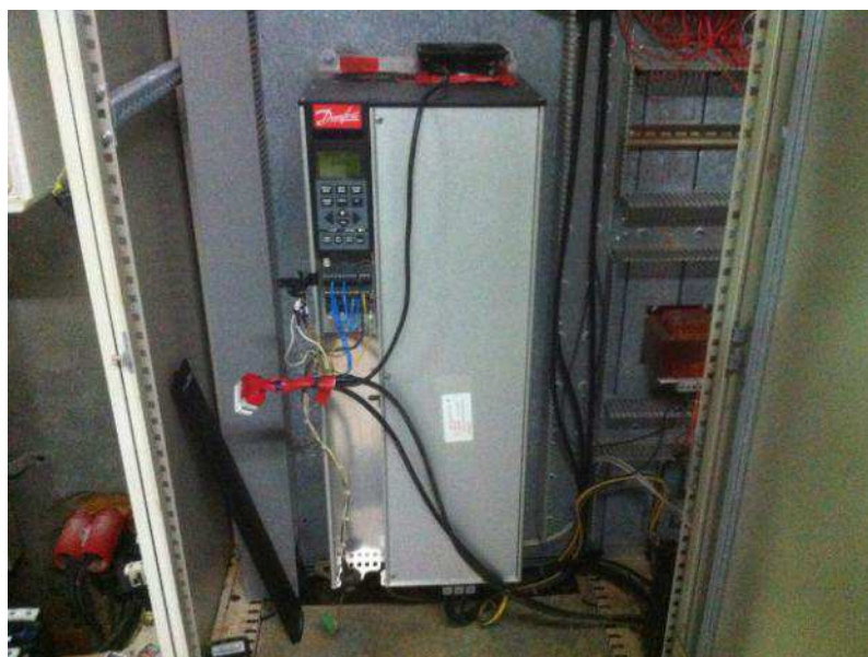
Foto 2. Variador inutilizado sustituido por un interruptor.
